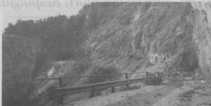
La terribile frana del 3 febbraio scorso ha danneggiato pesantemente la suggestiva «Ponale, la vecchia strada di collegamento tra la Busa e la Val di Ledro» (Foto Galas)
