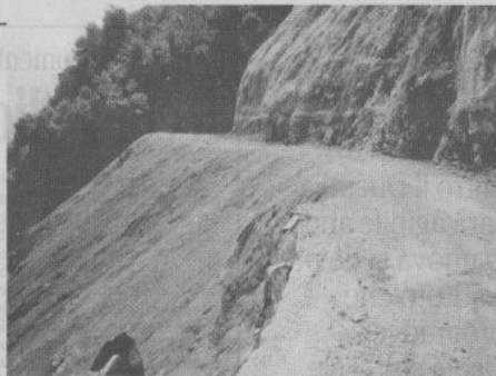
La Ponale, dopo la frana dello scorso febbraio
