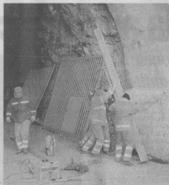
Troppo impegno per installare una semplice stanga
