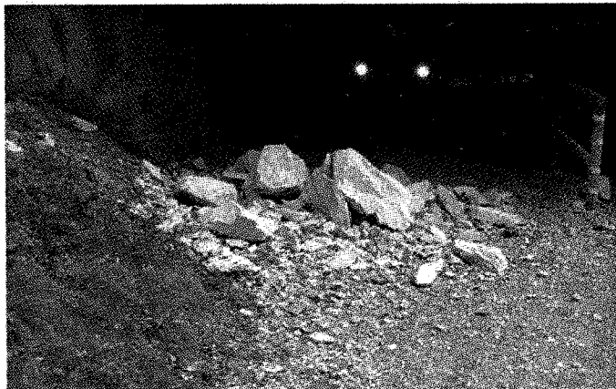
La piccola frana caduta sulla Ponale all'altezza della quarta galleria
